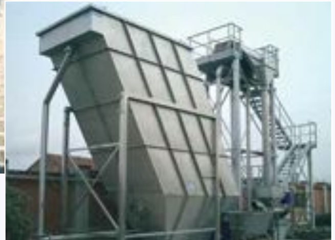
Tratamiento de aguas residuales industriales Q = 120 m 3 /h
