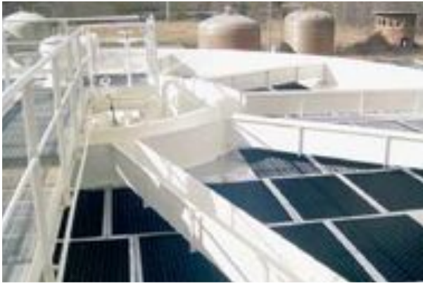
Estación tratamiento agua potable Q = 1.000 m 3 /h Año: 2005
