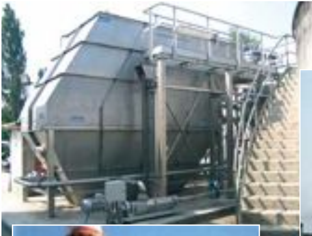
Tratamiento primario de aguas residuales urbanas Q = 55 m 3 /h
