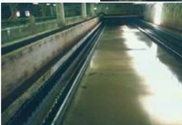
Tratamiento aguas urbanas (H.E. 36.000) Q = 400 m 3 /h Año: 1996
